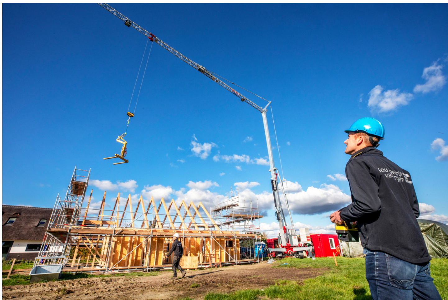
Ecologisch aannemer Jan-Willem van Engen bedient een elektrische kraan op een bouwterrein in Wageningen waar nagenoeg stikstofvrij wordt gebouwd. Beeld Raymond Rutting / de Volkskrant
